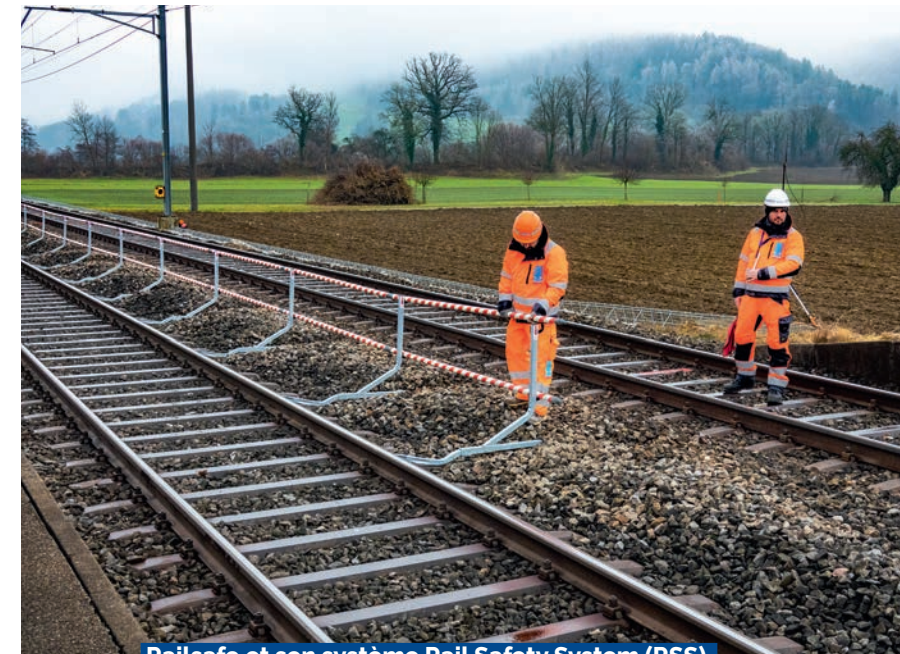
Railsafe et son système Rail Safety System (RSS)
