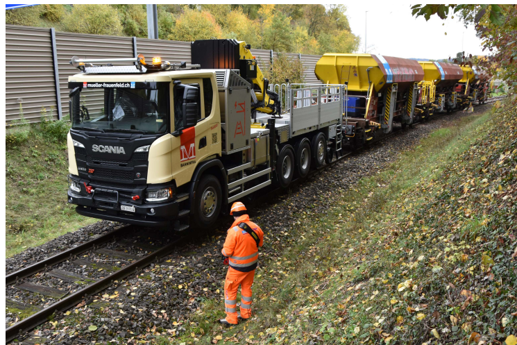
Opérations de maintenance par télécommande
