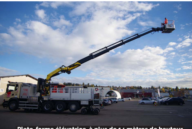
Plate-forme élévatrice à plus de 14 mètres de hauteur
